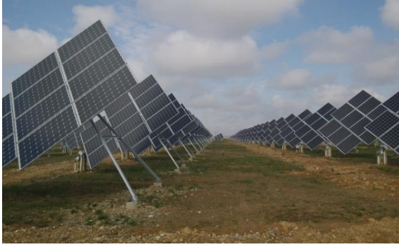
光伏发电系统
