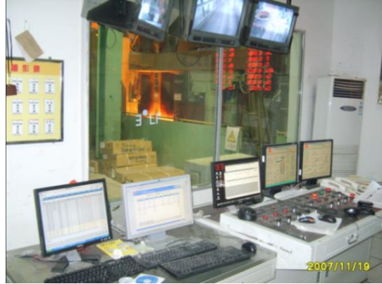
电弧炉精炼炉控制系统
